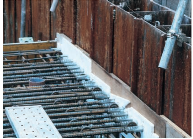
床版打ち継部 (II 型)
