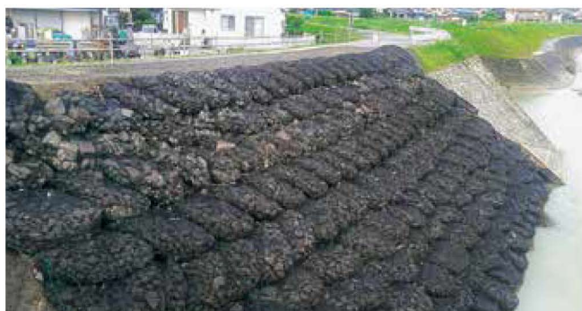
災害復旧 護岸ブロックが破壊された箇所の応急復旧として用いた事例
